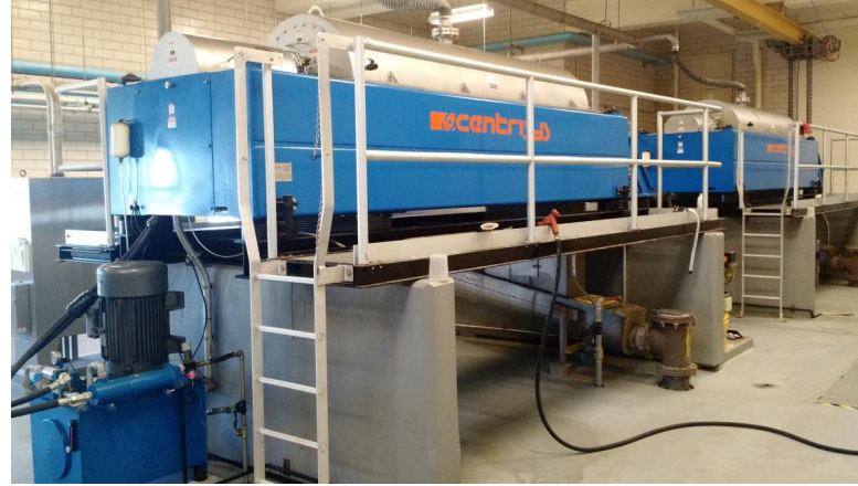
Dewatering centrifuges (Fond du Lac, WI)
